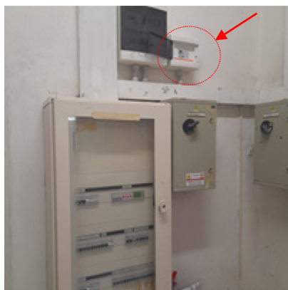
Fig.1. (a) Quadro elettrico di proprietà del Consorzio LaMMA, in cui andrà sostituito l'interruttore danneggiato
