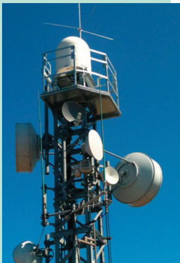
Le radar de Cima di Monte, île d'Elbe d'Elbe, installé par le Consorzio LaMMA dans le project ResMar
